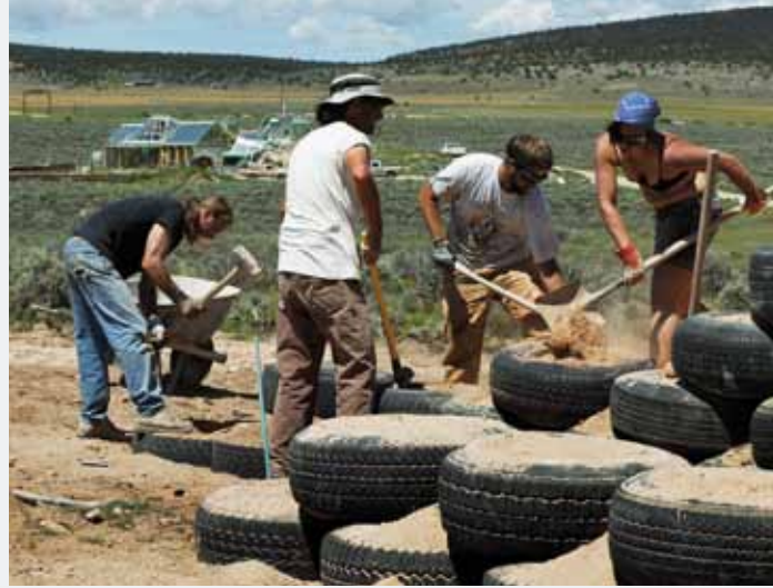
Les murs des earthships sont réalisés en compactant de la terre crue dans des pneus usagés.
